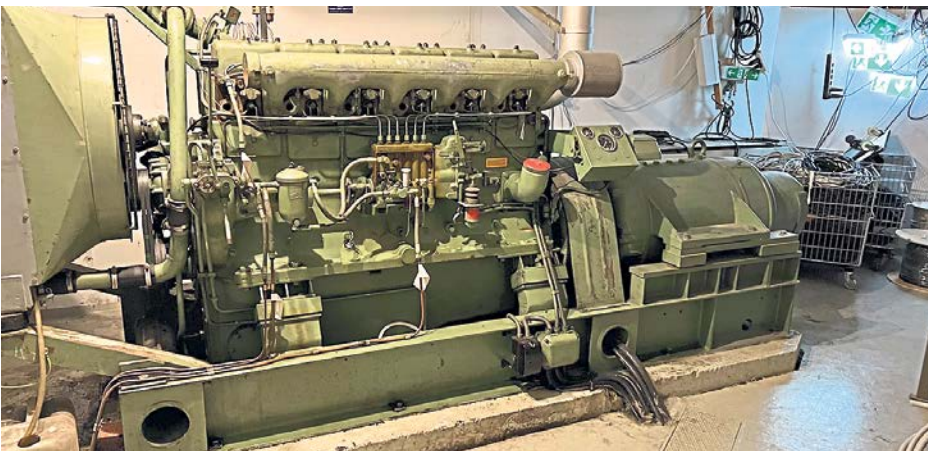
Das alte Notstromaggregat im Stadttheater.
