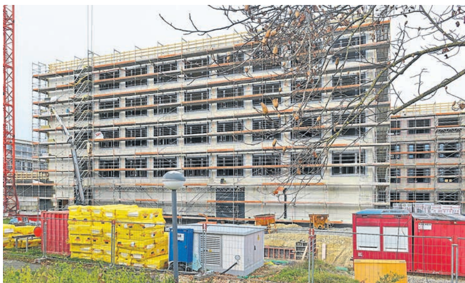
Der Rohbau steht: Ab dem Schuljahr 2025/26 werden in der Mittelschule Südost etwa 750 Kinder und Jugendliche unterrichtet.
