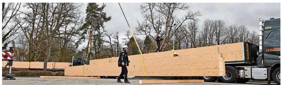
Mit drei Schwertransporten wurden die 23 Meter langen Bauteile der Dachkonstruktion von der Schweiz nach Ingolstadt gebracht.
