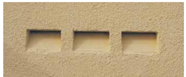
Fledermauskasten in Fassade integriert © Sylvia Weber
