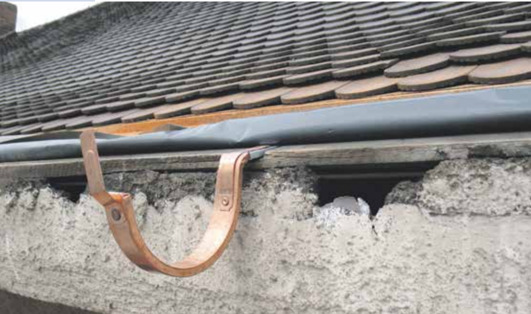
Ausbruch in Dachtraufe
