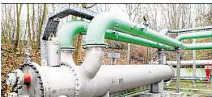
8. Die MVA nutzt das geklärte Wasser der ZKA zum Kühlen.
