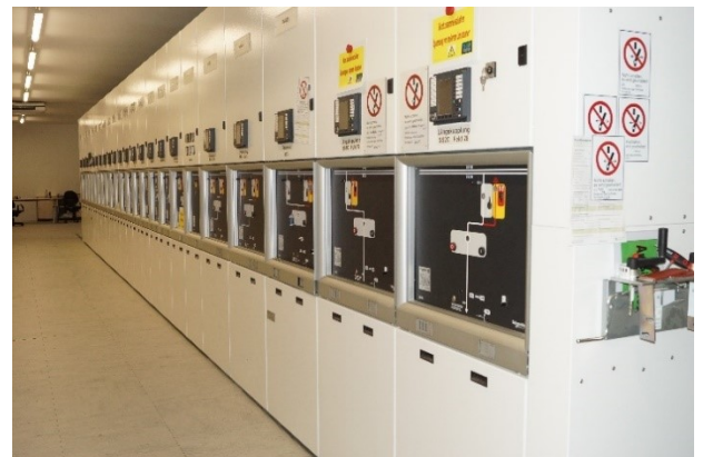
SWI – Neues Schalthaus Kothau
